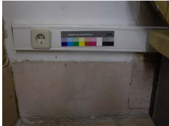
Figuras 11 e 12. Aspecto da coloração rosa; a sua presença no rodapé e paredes em pedra calcária.
